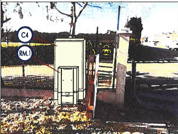
RM.1: Pose 1 Coffret Réseau + Pose 1 Coffret comptage C4 (BPS) (Branchement à Puissance Surveillée)
